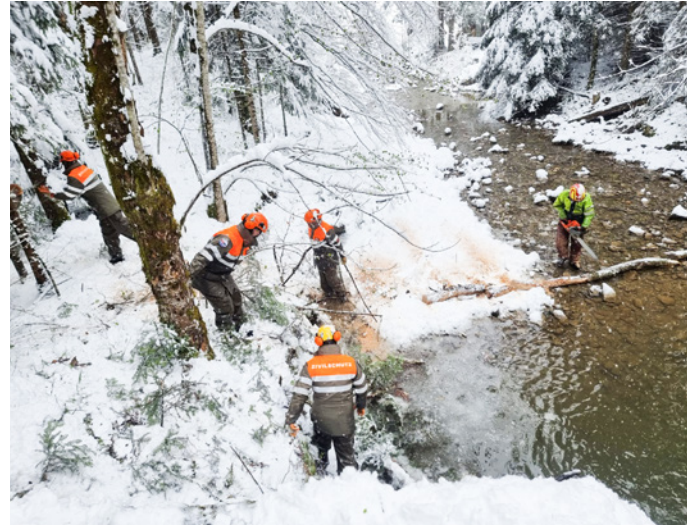
Der Unterhalt von Fließgewässern rund um den Pilatus ist ein präventive Arbeit, um Überschwemmungen bei Starkniederschlagsereignissen vorzubeugen.
