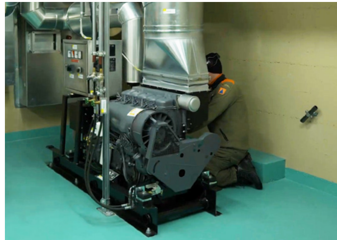
Unterhalt der Notstromaggregate in den Zivilschutzanlagen durch unsere Infrastrukturwarte.
